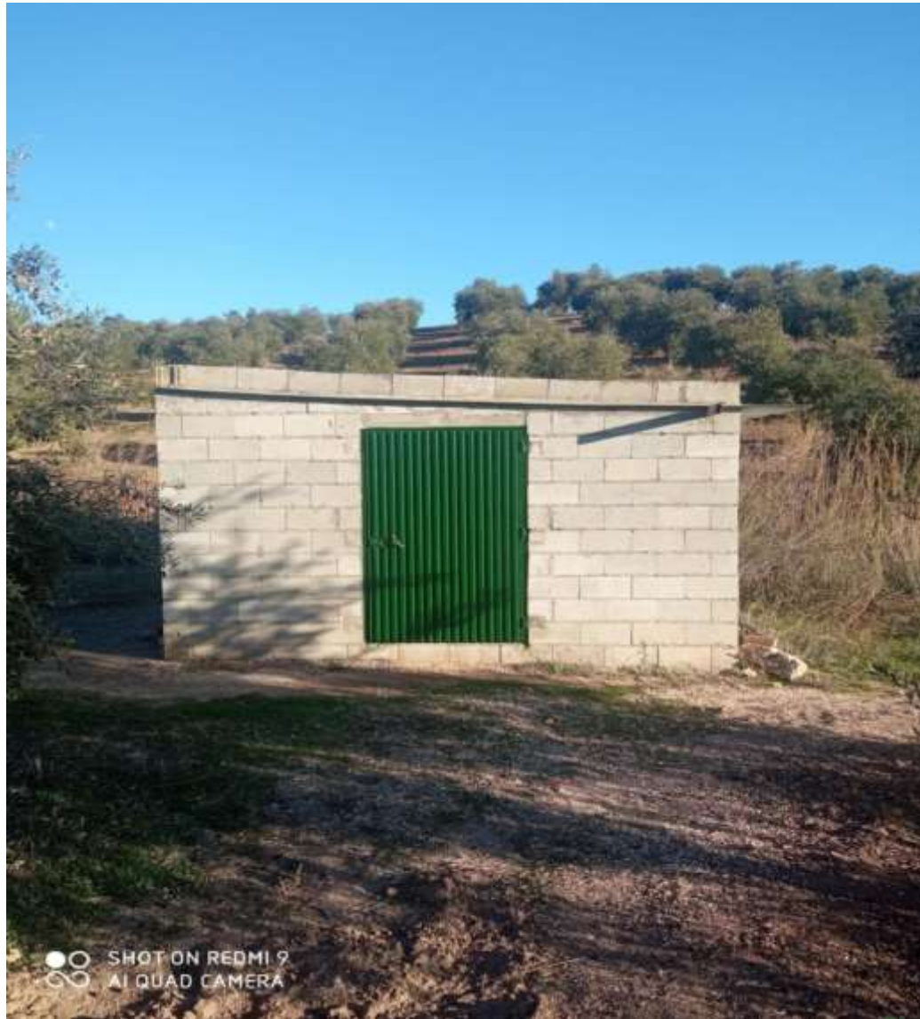
Caseta de la infraestructura de Abastecimiento de agua mediante pozo
