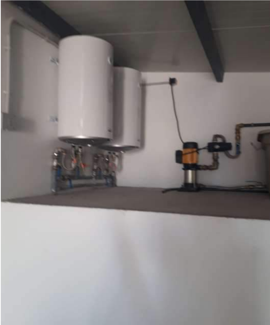
Grupo Bomba de abastecimiento a Calderas de 100 litro cada una.
