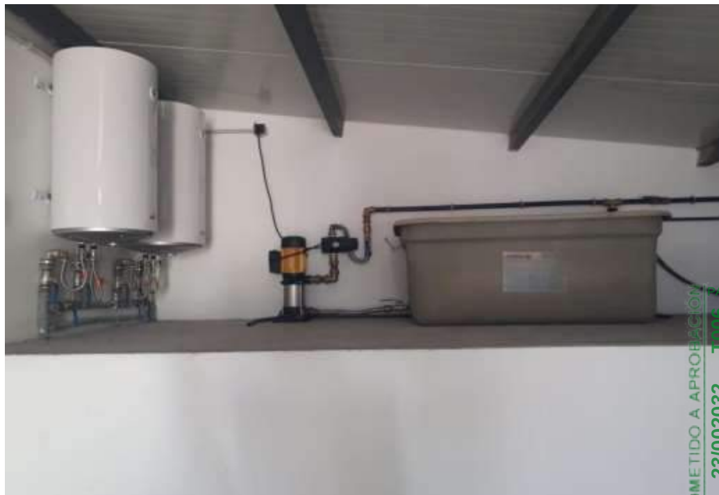
Abastecimiento de agua potable con depósito de 1500 litros.
