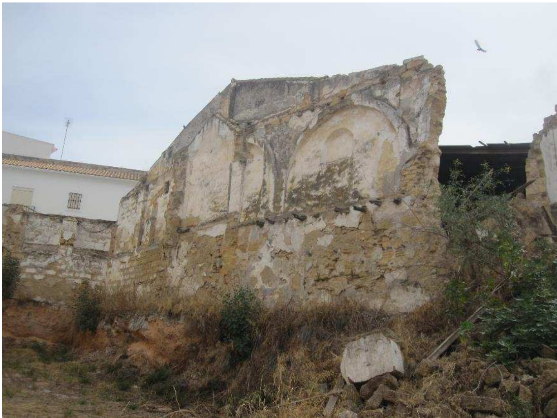
9.- RESTOS EDIFICACIONES ADOSADAS A MEDIANERA C/ CARMEN 25
