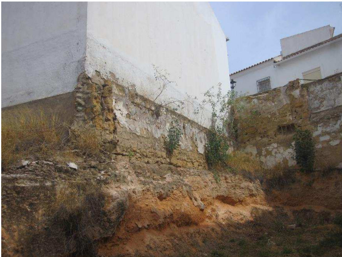
11.- CIMENTACIÓN EDIFICIO C/ HAZUELA Nº 18 TRAS EL VACIADO REALIZADO ILEGALMENTE QUE OBLIGA A REALIZAR NUEVO MURO MEDIANERO.
