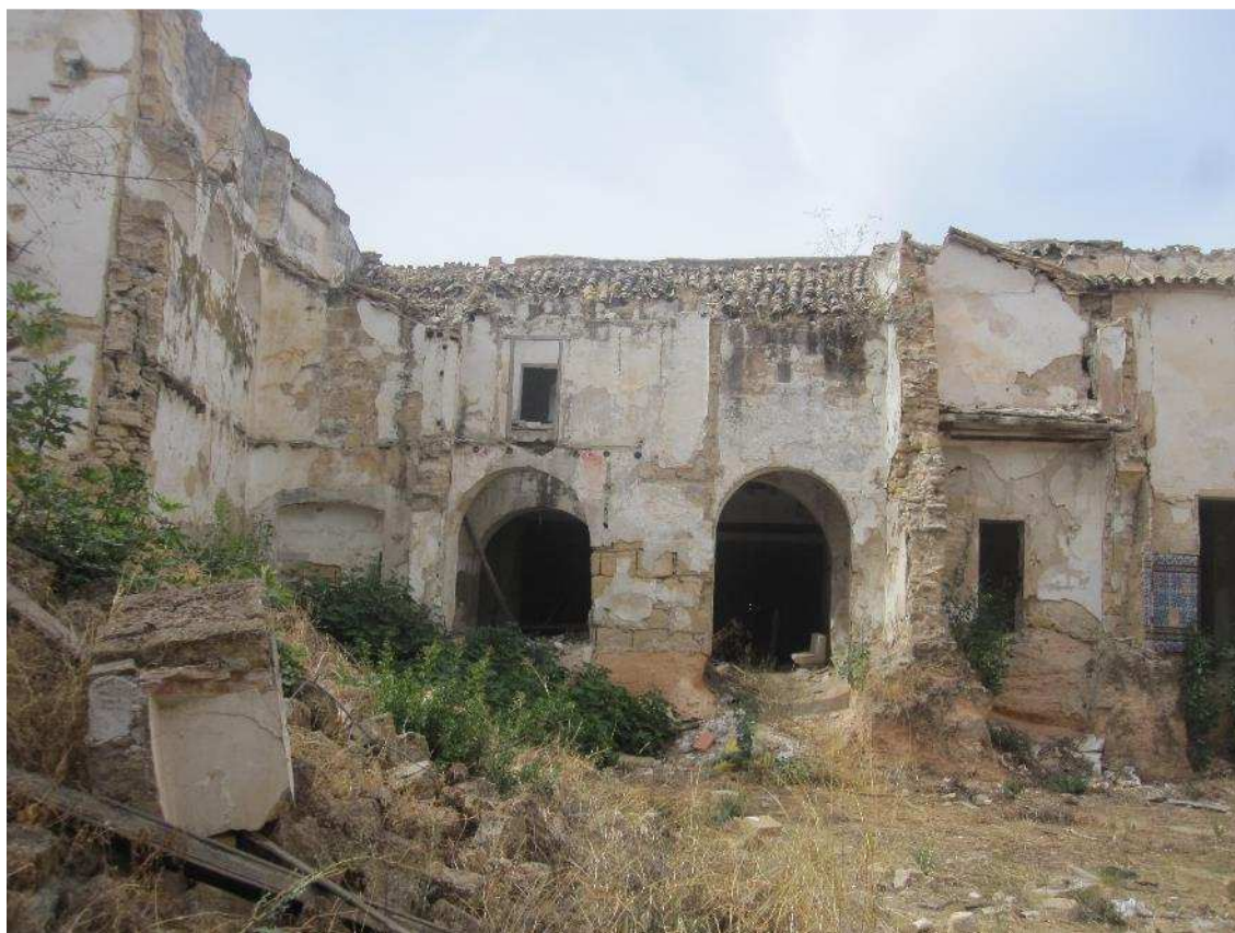
12.- RESTOS FACHADA TRASERA SEGUNDA CRUJÍA MURO MEDIANERO A RECONSTRUIR
