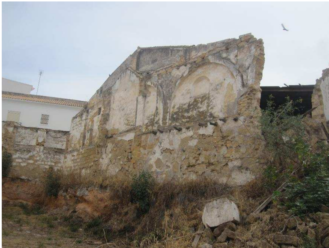
9.- RESTOS EDIFICACIONES ADOSADAS A MEDIANERA C/ CARMEN 25
