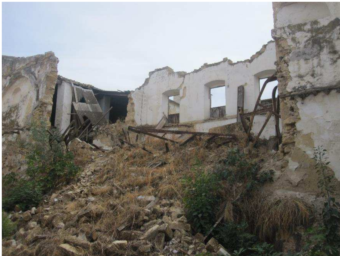
8.- RESTOS NAVE LATERAL C/ CARMEN 25, HUNDIDA COMO CONSECUENCIA DEL REBAJE REALIZADO EN C/ CARMEN 23
