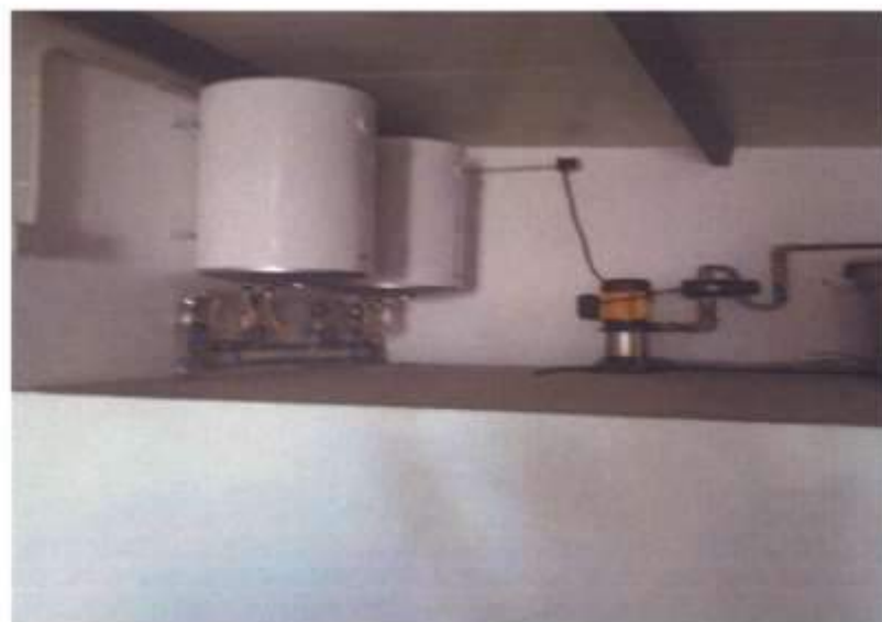
Grupo Bomba de abastecimiento a Calderas de 100 litro cada una
