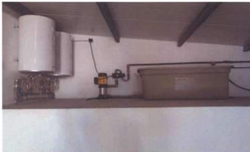
Abastecimiento de agua potable con depósito de 1500 litros.
