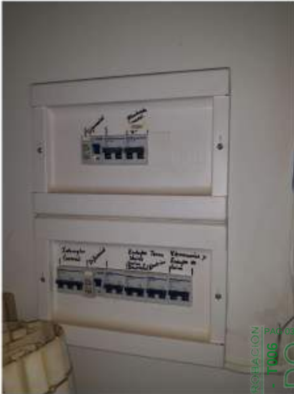
Cuadro eléctrico de cocina
