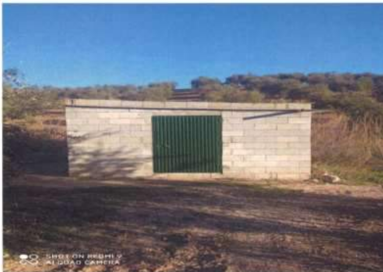
Caseta de la infraestructura de Abastecimiento de agua mediante pozo
